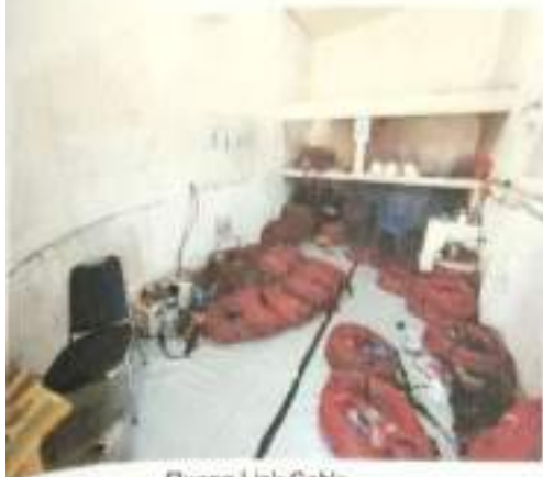
Ruang Link Cable
